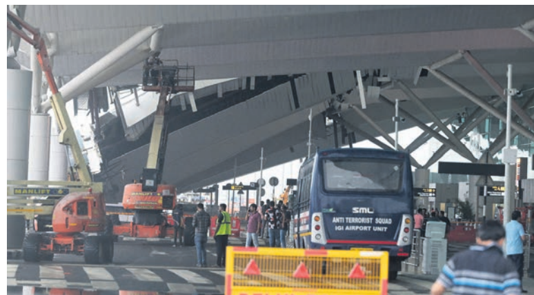
Effondrement, le 28 juin, d'un terminal de l'aéroport de New Delhi.
